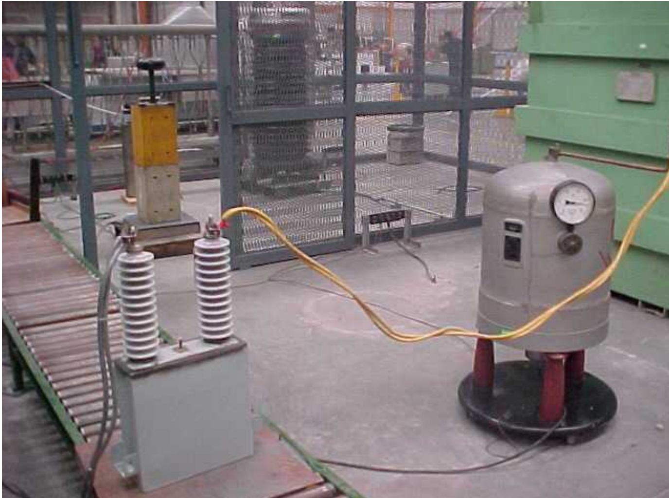
Unidad de Transformadores de Medida
