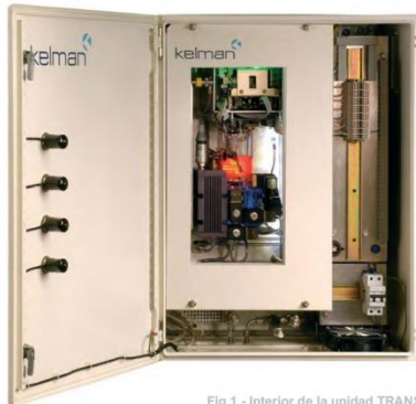
Fig 1 - Interior de la unidad TRANSFIX.
