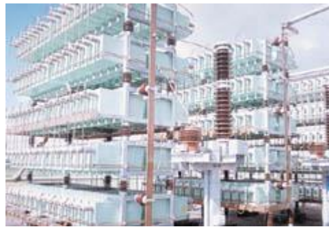
Instalaciones a la intemperie.
